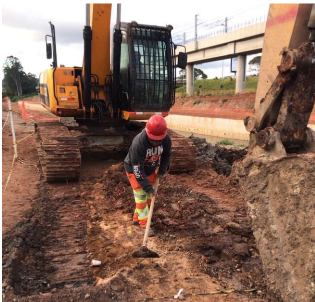
FOTO 6 – REMEDIAÇÃO DE VAZAMENTO DE ÓLEO DOS MAQUINÁRIOS
